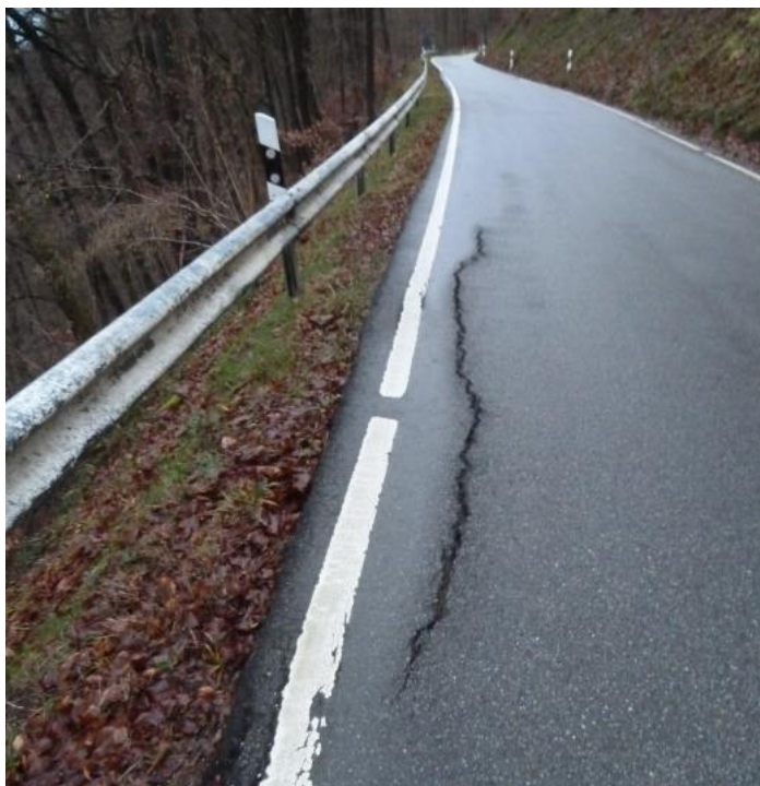
gerissener Asphalt infolge Böschungsrutschung
