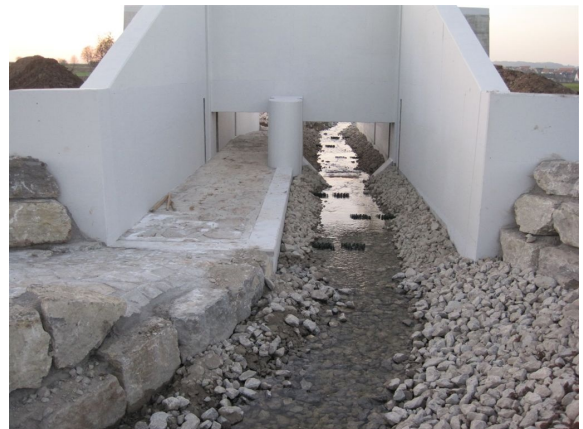
Zulaufbereich: Betriebsauslass und Ökogerinne
