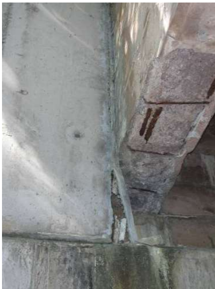
Schadstelle im Einbindebereich des Trägers in das Widerlager
