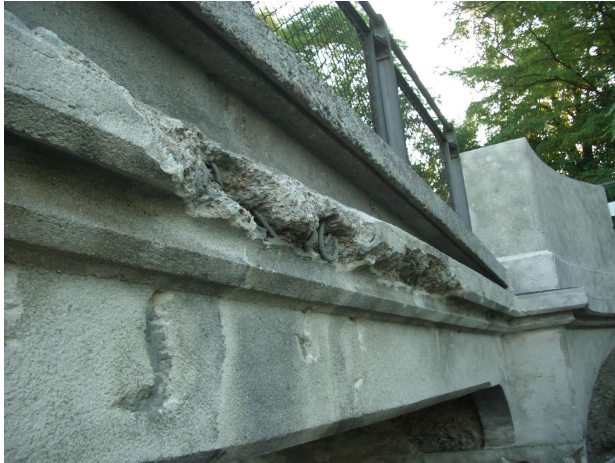
Detailansicht Schaden vor der Instandsetzung
