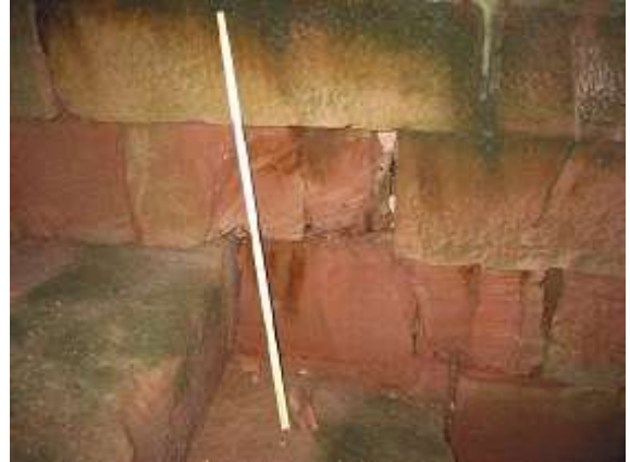
Mürbes und brüchiges Mauerwerk
