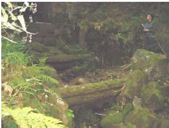
Auslaufbereich vor Instandsetzung
