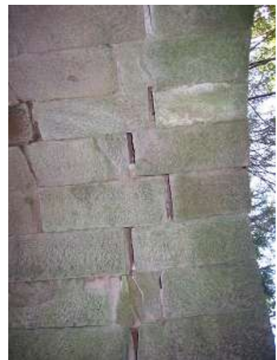
Ablösende Mauerwerksscheibe (talseitig)
