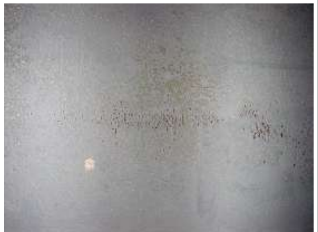
Ungenügend vorbereitete Stahloberfläche
