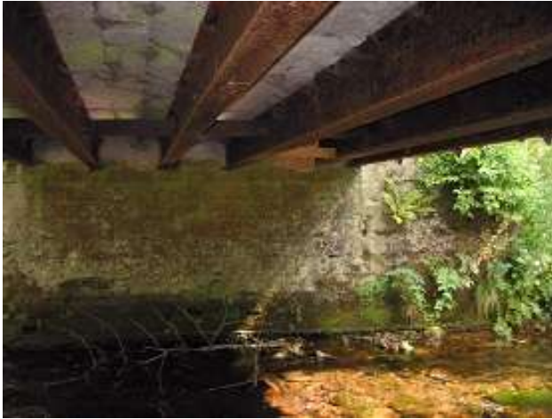
Widerlageransicht mit Auskolkung
