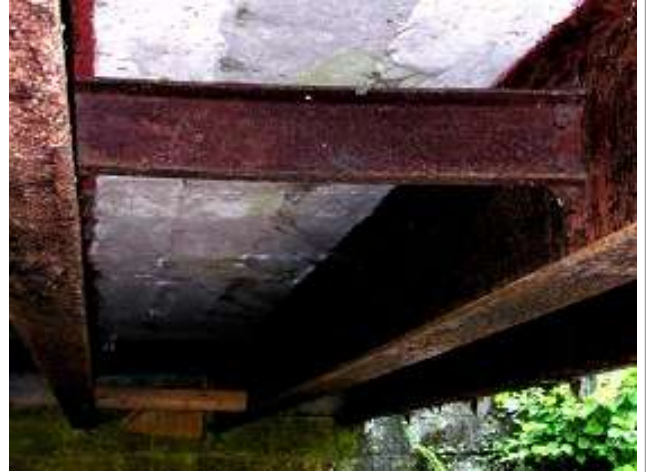
Stark korrodierte Stahlträger
